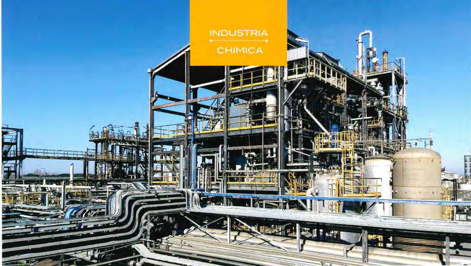
L'IMPIANTO CFS EUROPE DI RAVENNA
