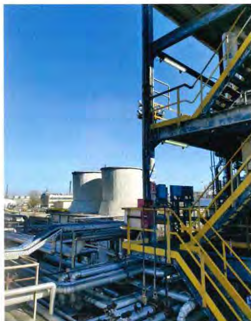
L'IMPIANTO DIFENOLI DI CFS EUROPE È BASATO SULLA TECNOLOGIA TS-1
